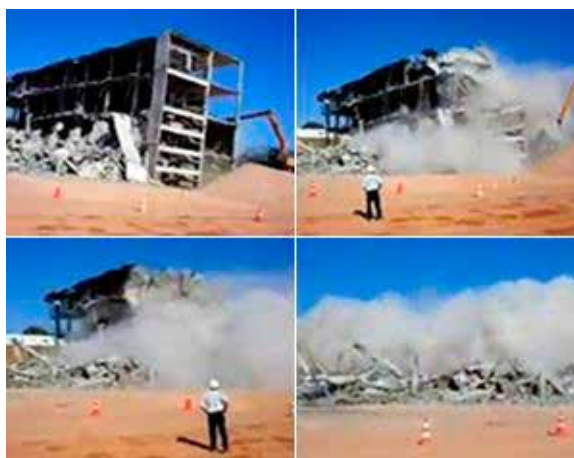
Figura 1. Desabamento da estrutura arquitetônica do shopping.
